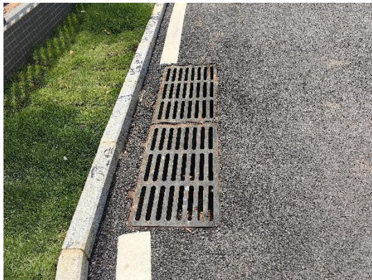
雨水管网、雨水口、检查井
